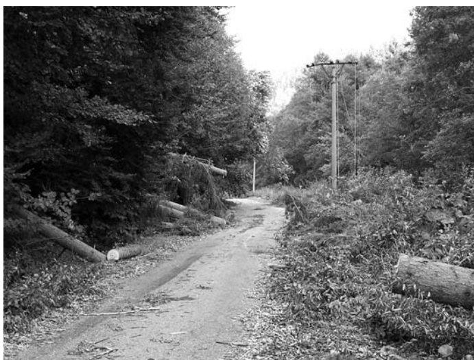
Vyvrátené a polámané stromy potrhali vodiče a poškodili stĺpy vysokonapäťového vedenia do Skorušiny
